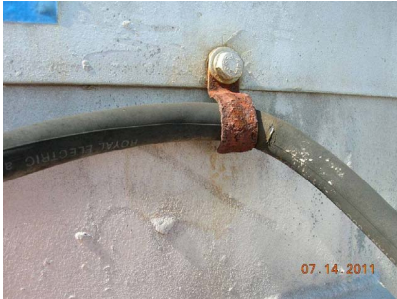
PHOTO 17: 572/4 Conduit & Junc. Box
