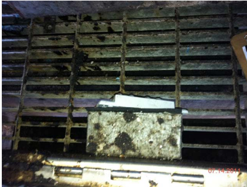
PHOTO 18: 572/4 Conduit & Junc. Box
