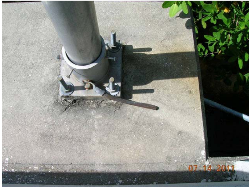
PHOTO 19: 572/4 Conduit & Junc. Box
