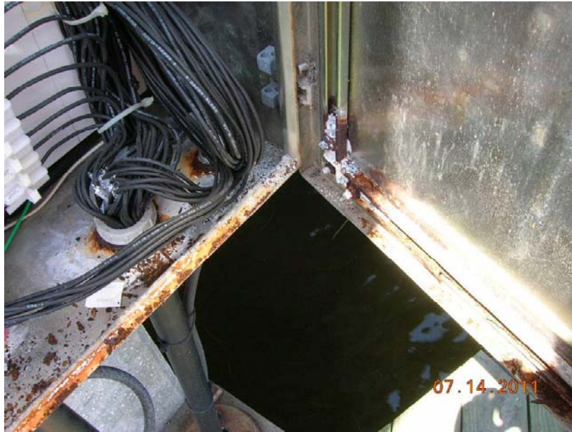
PHOTO 20: 572/4 Conduit & Junc. Box
