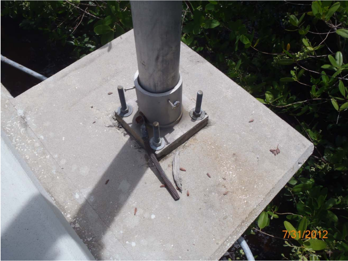
PHOTO 6: 572/4 - Conduit & Junc. Box
