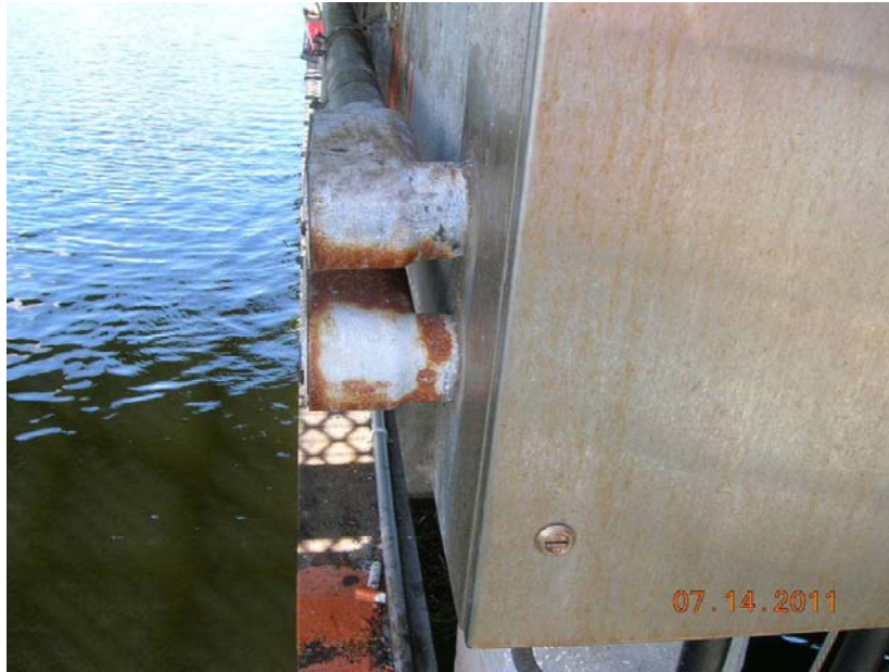
PHOTO 16: 572/4 Conduit & Junc. Box
