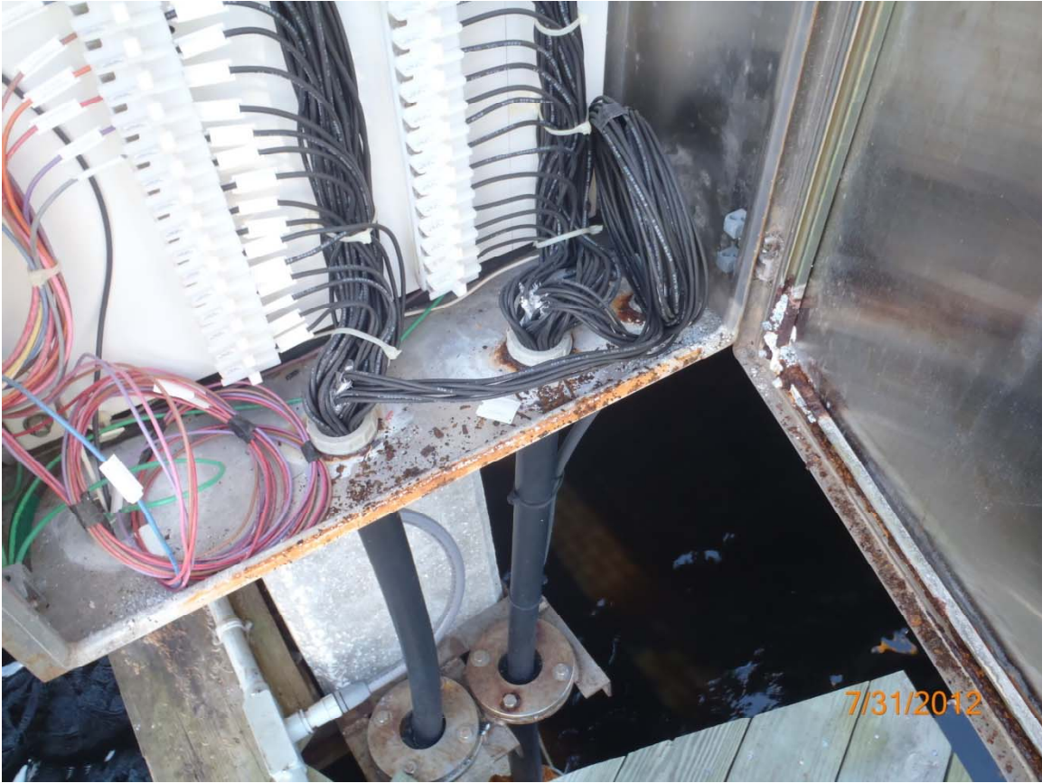
PHOTO 7: 572/4 - Conduit & Junc. Box
