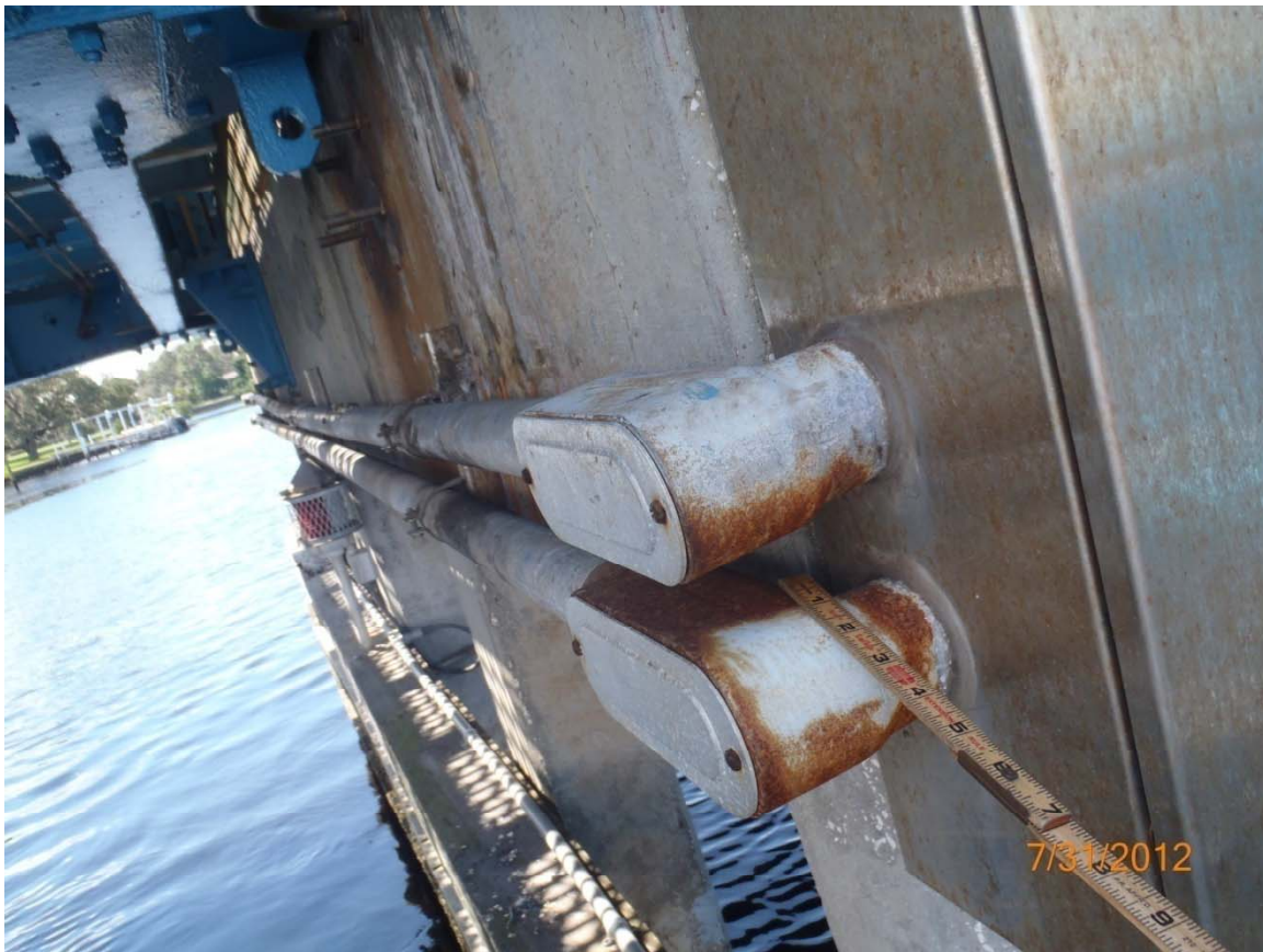
PHOTO 5: 572/4 - Conduit & Junc. Box
